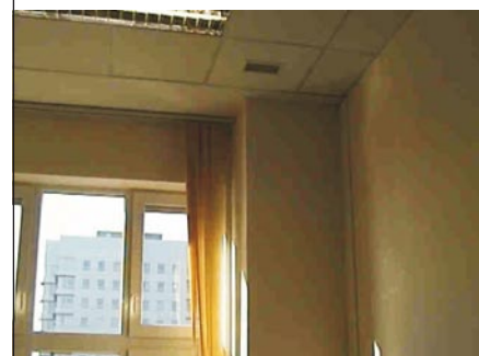
Infiltracja powietrza zewnętrznego do przestrzeni ostony filara konstrukcyjnego
