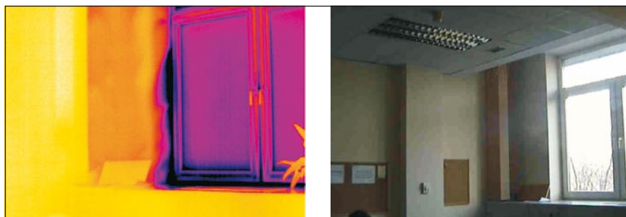
Przedmuchy w połączeniu rama – ściana
